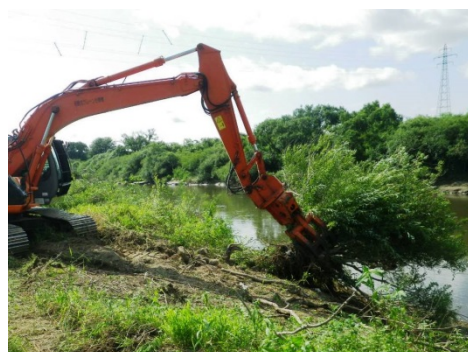
▲河川敷地内にある治水上支障となる樹木を伐採している様子
