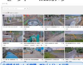
全現場を統一して管理。WEBパトロール可能 洪水発生時は現場にいかなくても被害状況確認可
