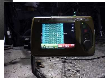
3DMCアスファルトフィニッシャーのモニター表示
