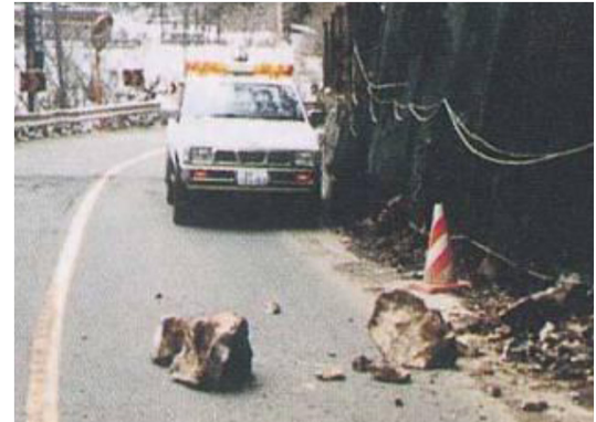
▲現道の落石状況
