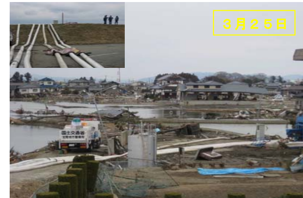
東松島市浜市地区で排水ポンプ車により24時間体制で排水作業を実施
