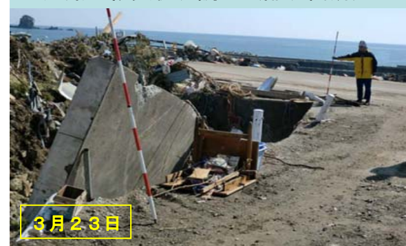
道路の被災状況調査（陥没箇所）
