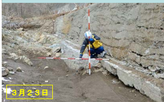
準用河川の被災状況調査（護岸）
