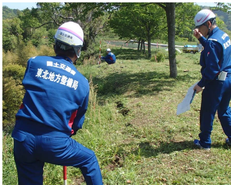
▼道路調査班による被災状況調査 (甲佐町内)
