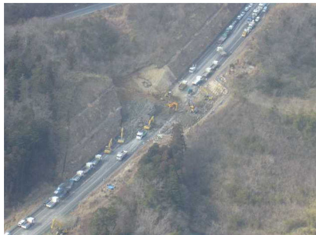
E6常磐道 相馬IC~新地ICの被災状況確認
