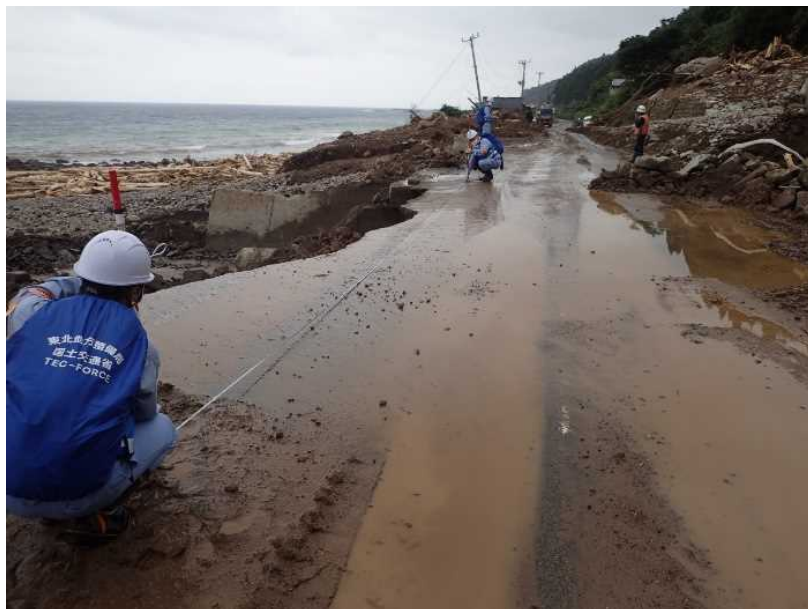
被災状況調査（青森県風間浦村）
