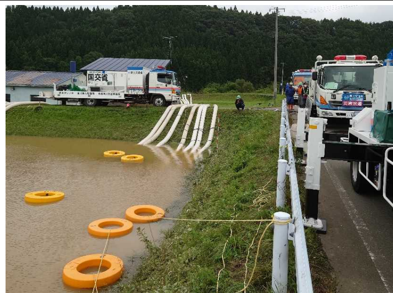
排水ポンプ配置状況（青森県東北町）
