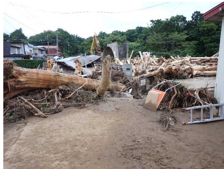
橋梁部付近での流木による閉塞状況(青森県むつ市)
