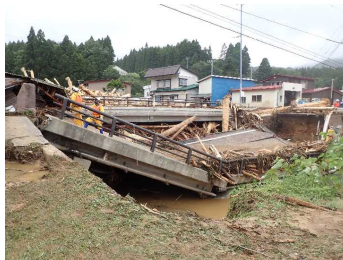
橋梁の被災状況
