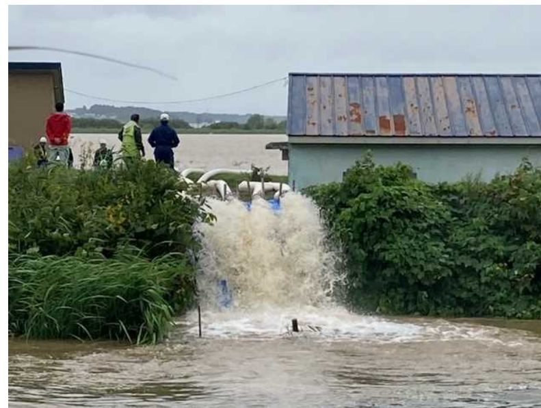
排水状況（青森県東北町）
