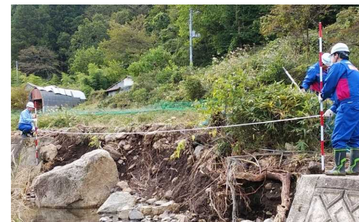
被災状況確認(河川)(宮城県丸森町・小屋柵川)
