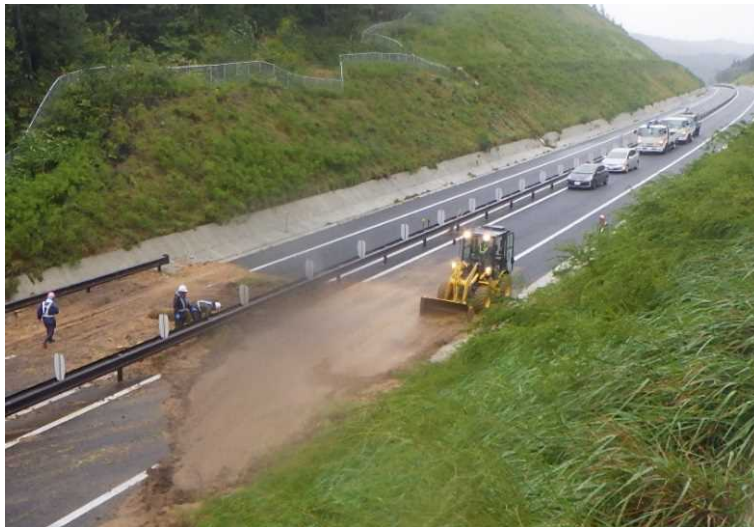
土砂撤去状況(山田宮古道路 山田北IC～宮古南IC)
