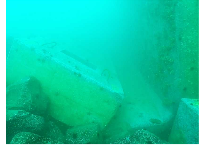
撮影年月日：R1.11.18 潜水土の撮影による滑動ケーソンの基礎部分被災状況
