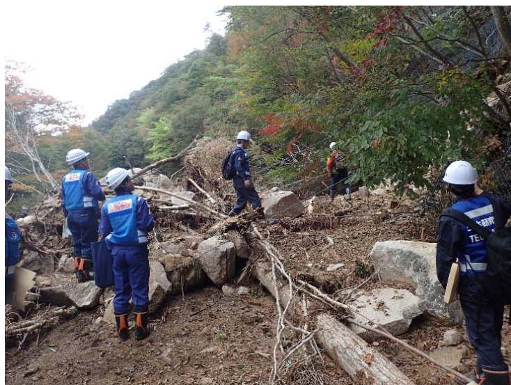
法面崩落箇所の状況確認
