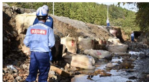
▲TEC-FORCEによる被災状況調査(福島県相馬市)
