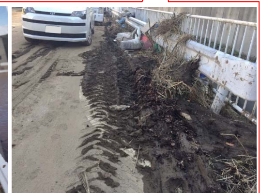
土砂堆積状況
