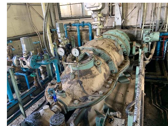
ポンプ施設の被災状況(浸水痕跡)
