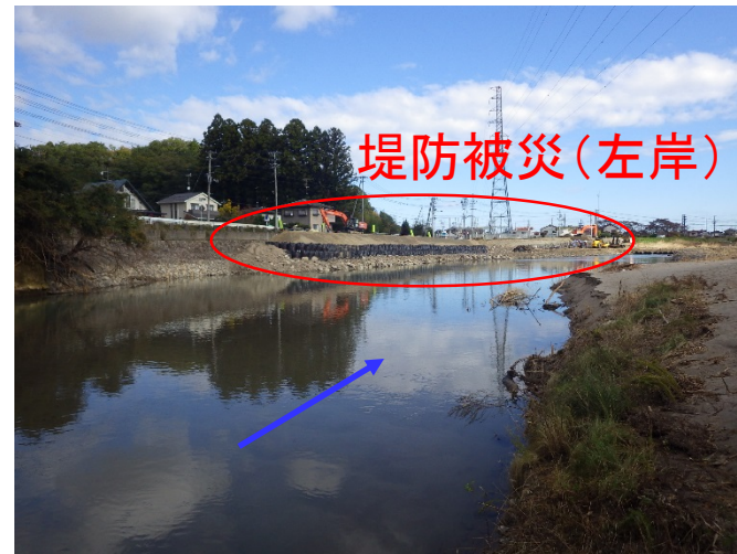
現地状況調査 宇多川(被災箇所竹林下流) (福島県相馬市 宇多川)
