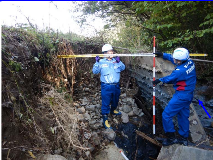
被災状況調査(左岸護岸崩落) (福島県相馬市 町場川)
