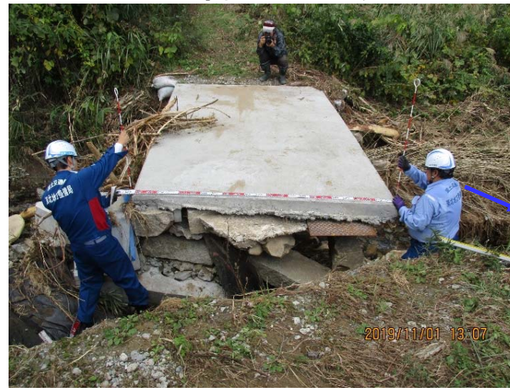
被災状況調査(右岸洗掘、橋崩落) (福島県相馬市 町場川左支川)
