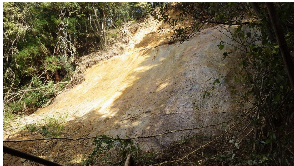
南相馬市原町区北新田東畑地内 河道閉塞箇所上部法面崩落状況
