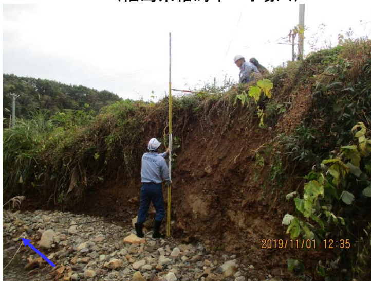
被災状況調査(右岸側河岸洗掘) (福島県相馬市 町場川左支川)
