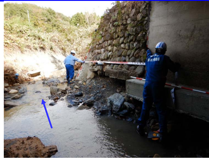
被災状況調査(橋護岸背面洗掘) (福島県相馬市 町場川)
