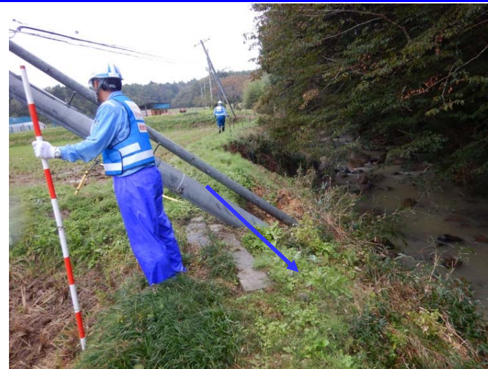
被災状況調査(右岸側電柱転倒) (福島県相馬市 一本木池支川)
