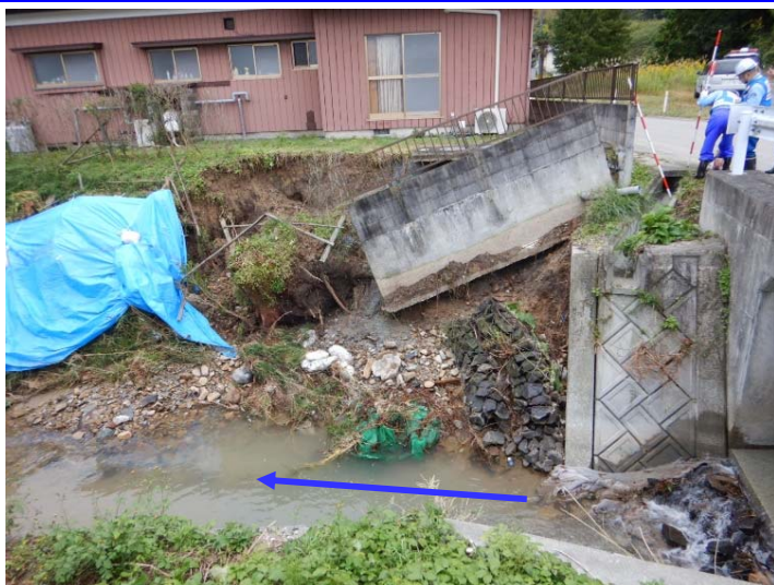
被災状況調査(右岸側民家擁壁崩落) (福島県相馬市 日下石川支川)
