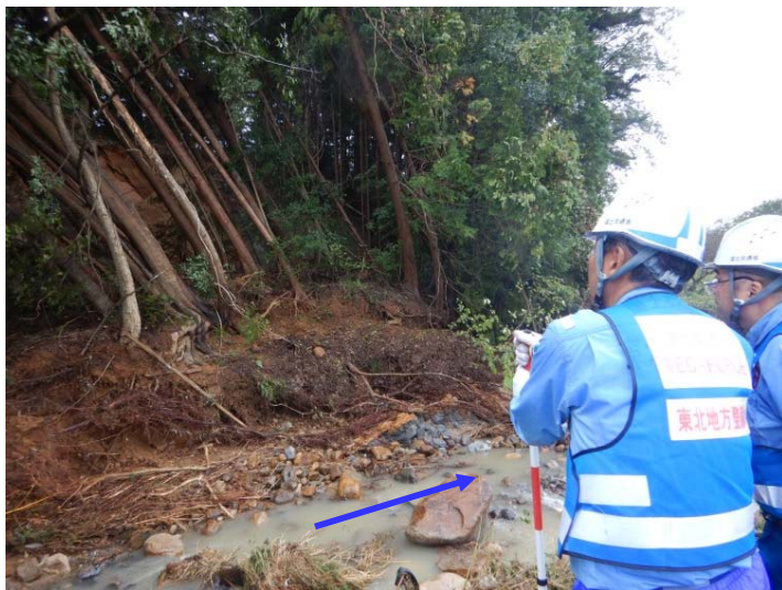
被災状況調査(左岸側背後地山崩落) (福島県相馬市 一本木池支川)
