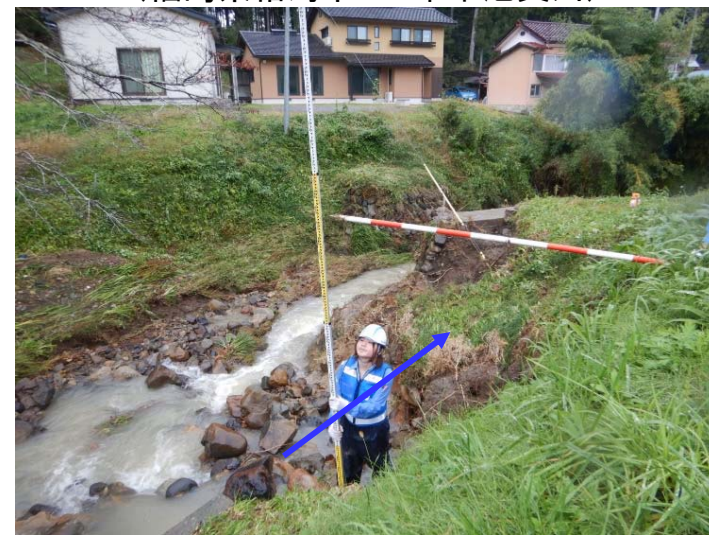
被災状況調査(右岸側自然河岸崩落) (福島県相馬市 一本木池支川)
