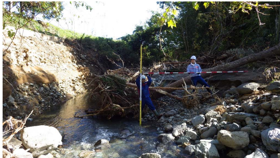
南相馬市鹿島区上栢窪地内 西沢川の被災状況確認(土砂流木等堆積)
