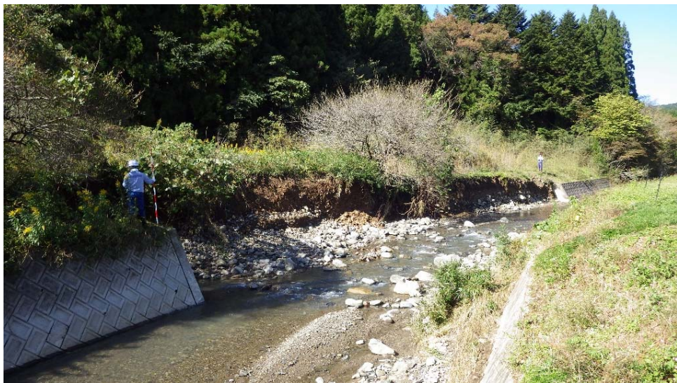
南相馬市鹿島区栢窪地内 北ノ入川の被災状況確認(河岸洗掘)
