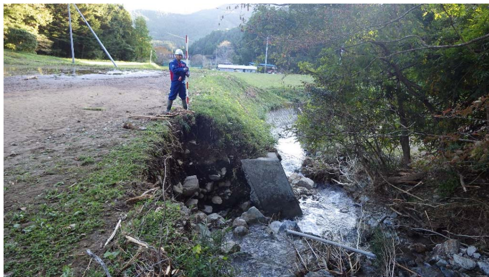
南相馬市原町区大原地内 川子迫川の被災状況確認(端末部洗掘)
