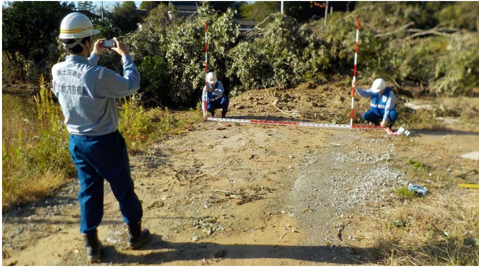
被災状況調査を実施 (福島県相馬市 市道1577線)
