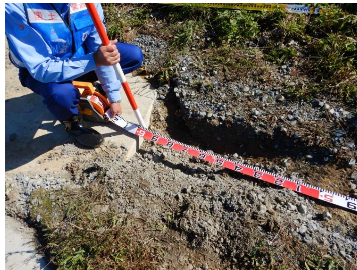
被災状況調査(路面深掘れ) (福島県相馬市 市道1605)
