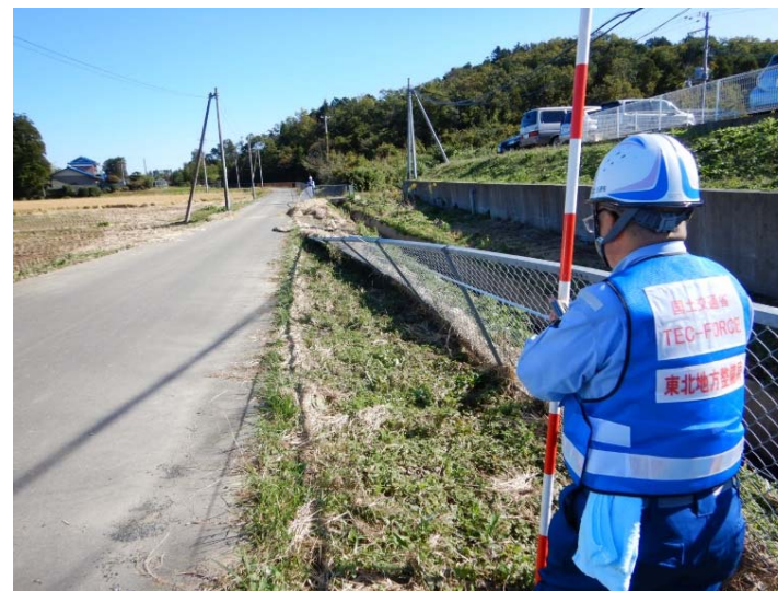
被災状況調査(立入防止柵転倒) (福島県相馬市 市道1525)
