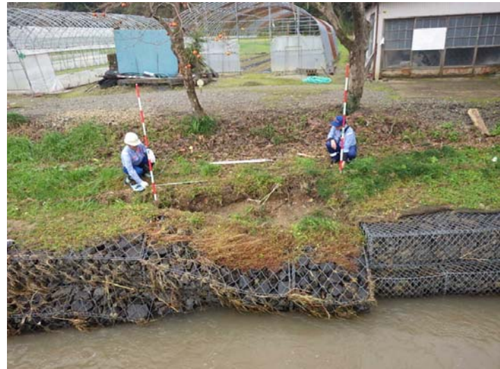
被災状況調査状況(調査③) 宮城県角田市 桜井川 被災状況(かご崩落)
