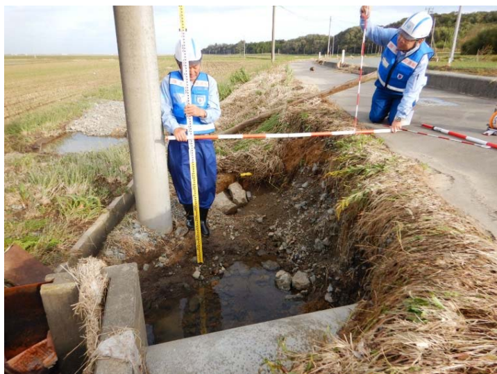
被災状況調査(路肩崩落) (福島県相馬市 市道1470)
