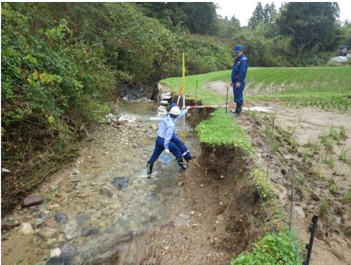
被災状況調査状況(調査②) 宮城県角田市 桜井川 被災状況(河岸洗掘)
