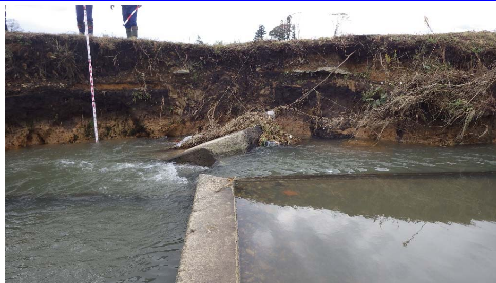
南相馬市原町区萱浜地内 北原川の被災状況確認(床固工流失)
