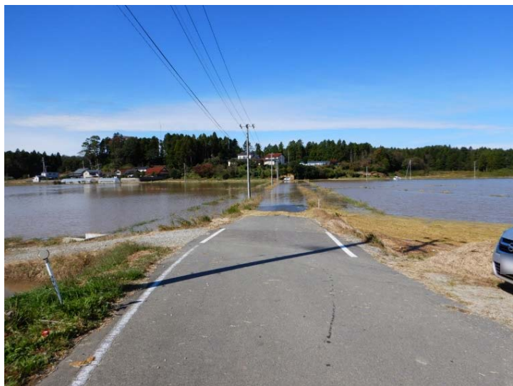
被災状況調査(冠水) (福島県相馬市 市道1211)
