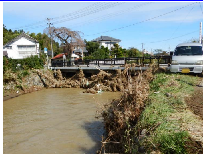
被災状況調査(橋梁部ゴミつまり) (福島県相馬市 2級河川小泉川)
