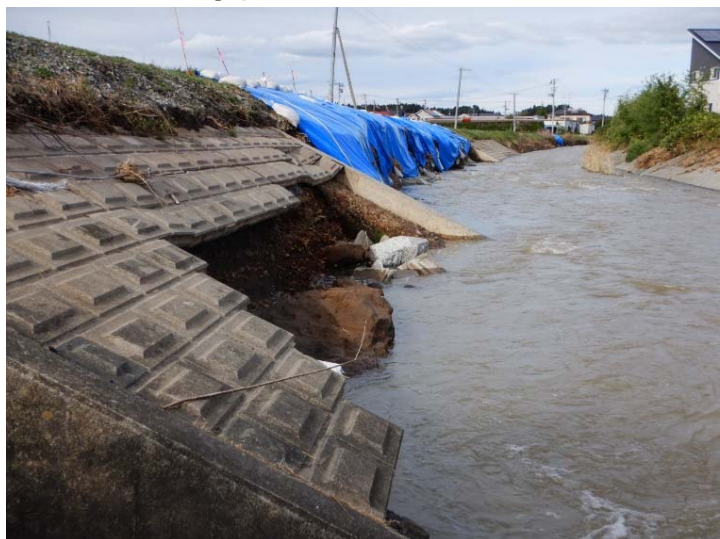
被災状況調査(ブロック張り崩落) (福島県相馬市 小泉川右支川)
