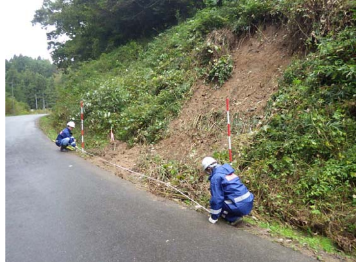
被災状況調査状況(調査①) 宮城県角田市 市道205号 被災状況(法面崩落)
