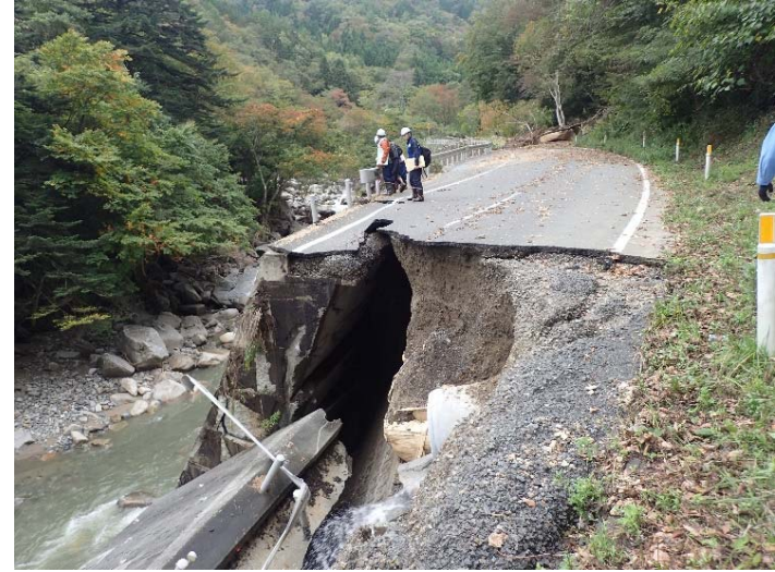
河床洗掘による道路崩落箇所 の状況確認
