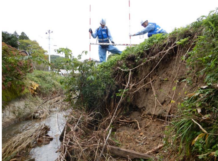
被災状況調査状況(スタッフによる計測) (福島県相馬市 支川日下石川(上流))
