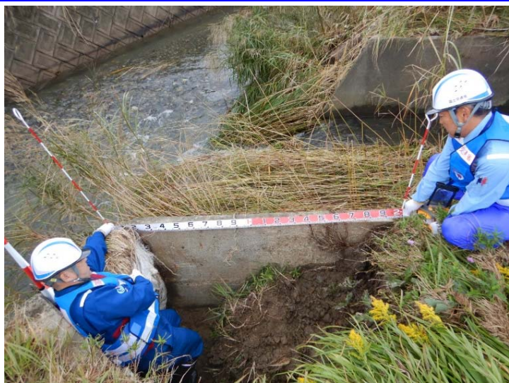
被災状況調査状況(巻き尺による計測) (福島県相馬市 支川日下石川(下流))
