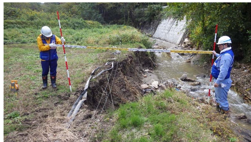
被災状況調査状況 福島県伊達市 七郎沢川 被災状況
