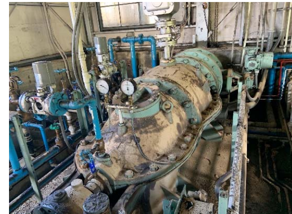
ポンプ施設の被災状況(浸水痕跡)
