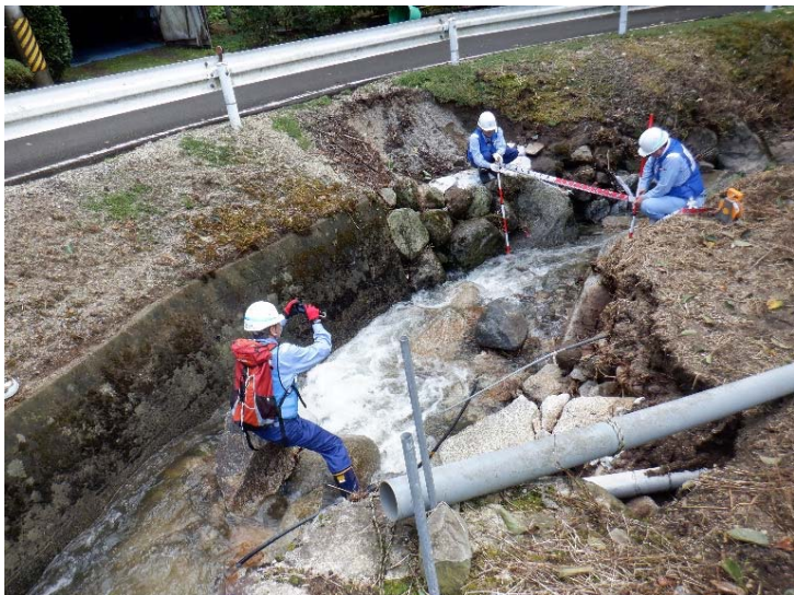
被災状況調査状況 福島県伊達市 御戸内川 被災状況
