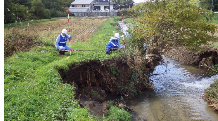
被災状況調査状況 福島県伊達市 石田川支線 被災状況
