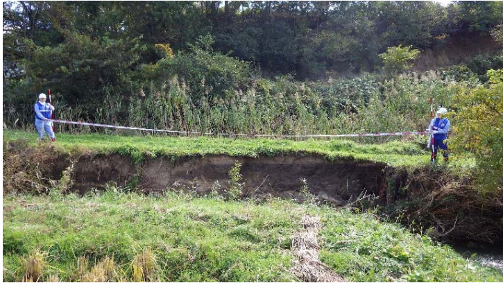
被災状況調査状況 福島県伊達市 石田川支線 被災状況
