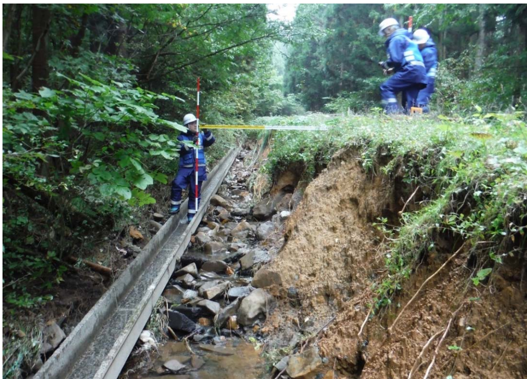
被災状況調査状況 (福島県相馬市 市道2-30 ヤッコレ線 )
