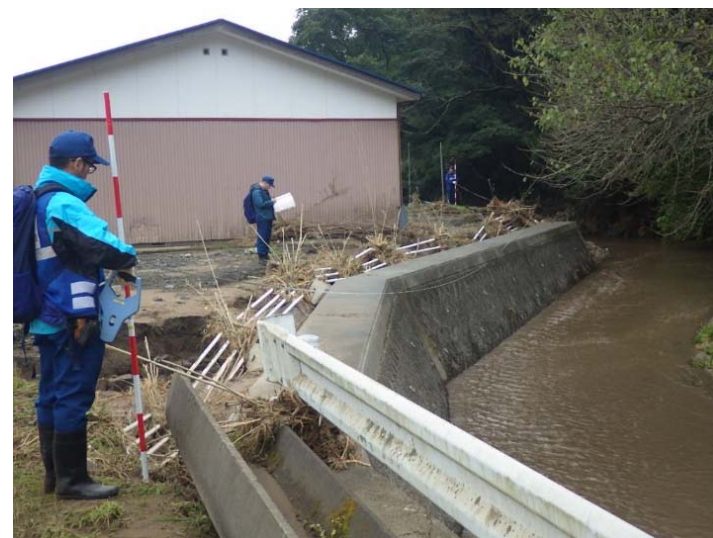
被災状況調査状況 宮城県角田市 笠島川 被災状況(護岸吸い出し)
