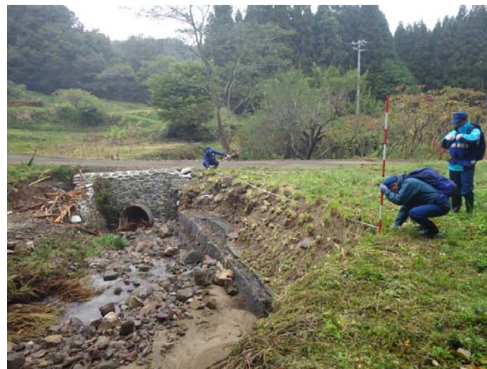
被災状況調査状況 宮城県角田市 尾袋川 被災状況(法面洗掘)
