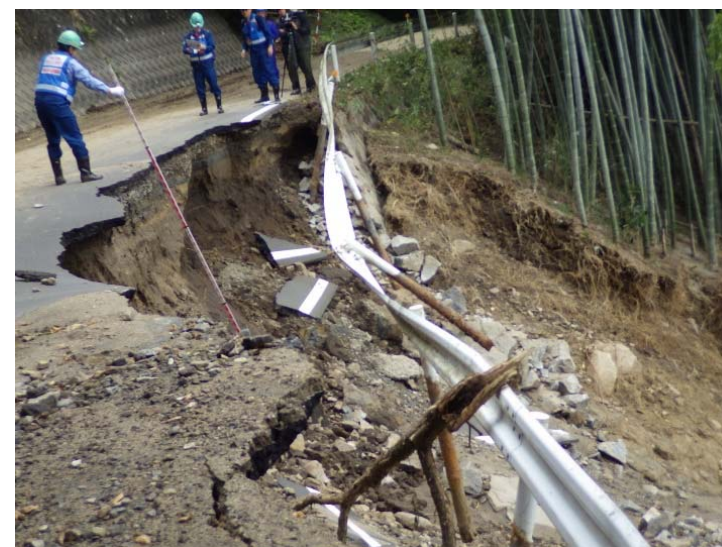
被災状況調査 (宮城県丸森町 R349)
