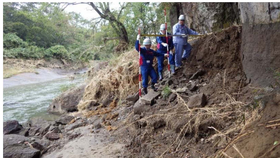
三十三観音史跡公園(園路 崩落) (福島県矢吹町滝八幡地区)
