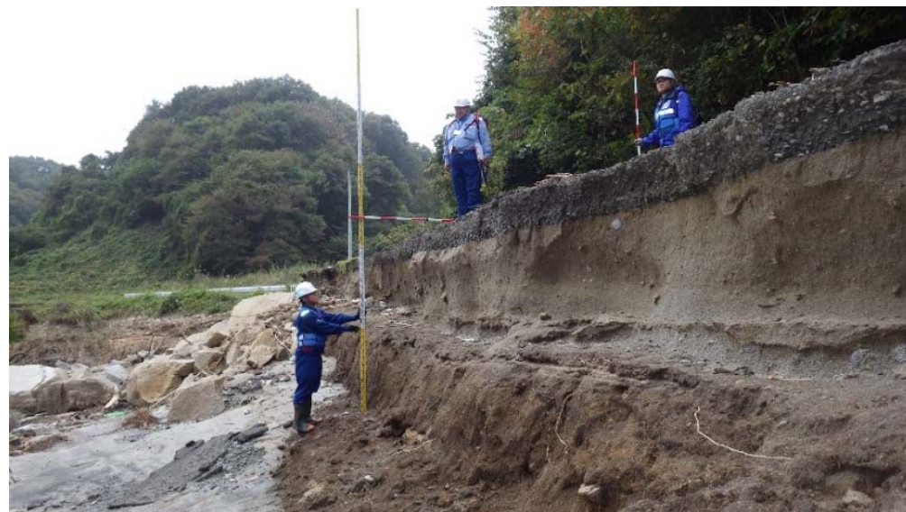
被災状況調査状況 福島県田村郡三春町 305 西ノ内石倉線 被災状況
