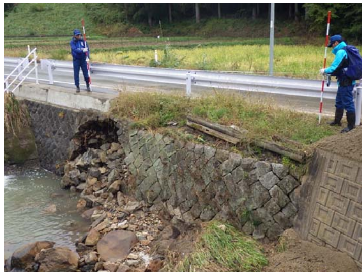
被災状況調査状況 宮城県角田市 高倉川 被災状況(護岸崩落)
