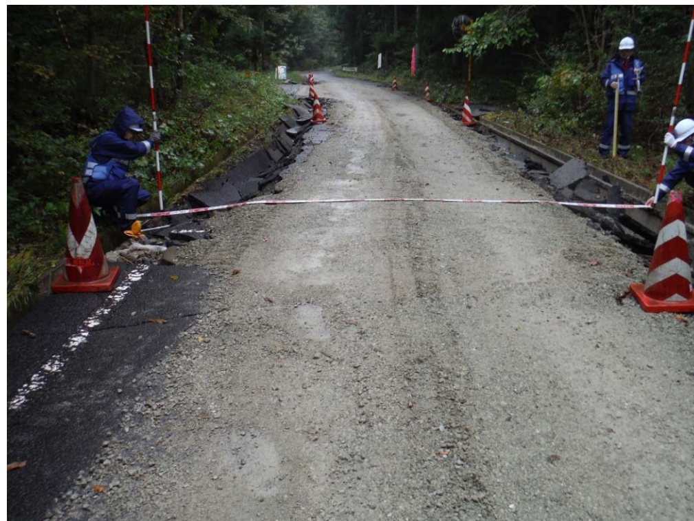
被災状況調査状況 (福島県相馬市 市道2-30 ヤッコレ線)
