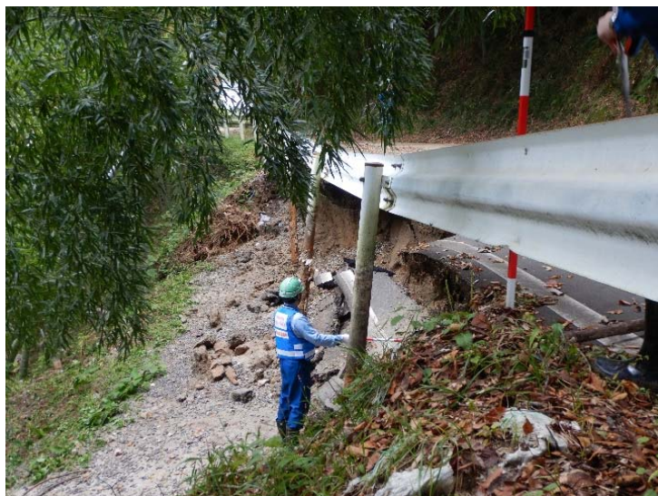
被災状況調査 (宮城県丸森町 R349)
