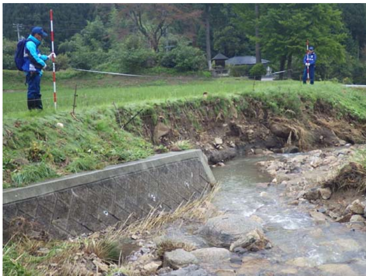
被災状況調査状況 宮城県角田市 笠島川 被災状況(洗掘)
