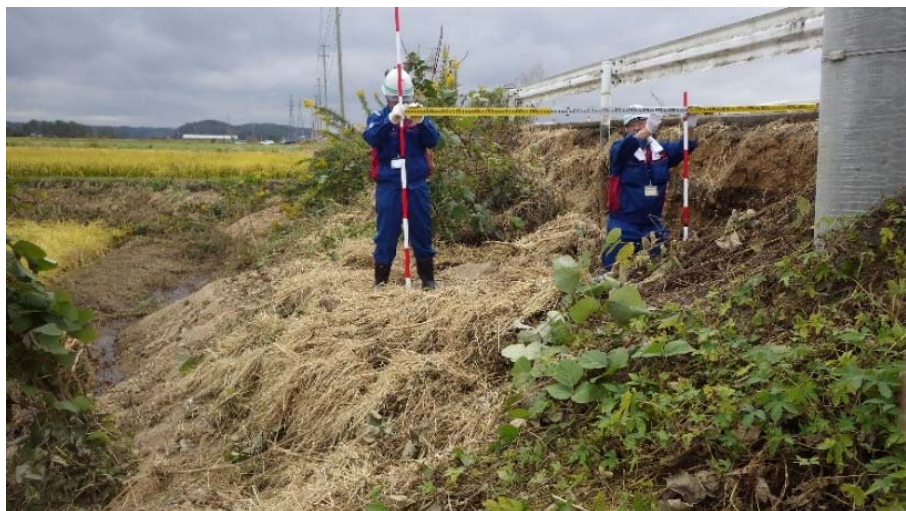
町道 明新陣ヶ岡線 崩落状況の調査 (福島県矢吹町陣ヶ岡地区)
