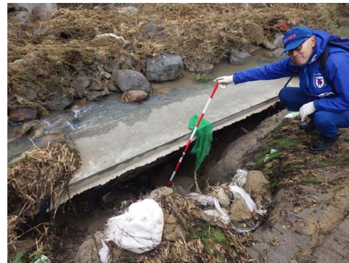
被災状況調査状況 宮城県角田市 高倉川 被災状況(護岸吸い出し)
