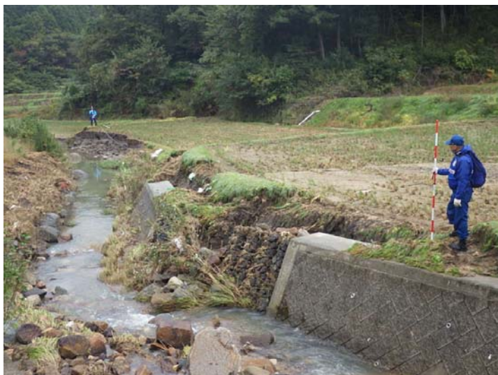
被災状況調査状況 宮城県角田市 高倉川 被災状況(護岸崩落)
