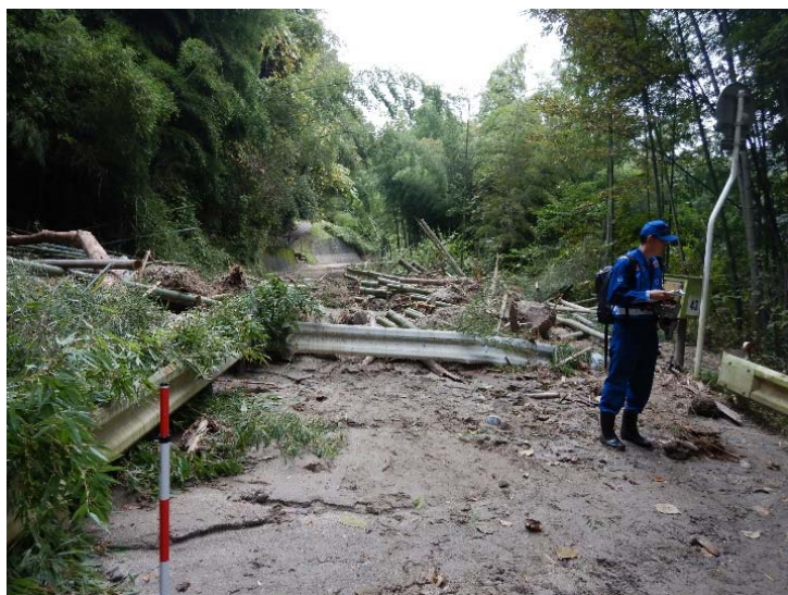
被災状況調査 (宮城県丸森町 R349)
