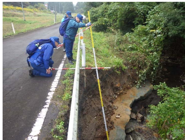
被災状況調査状況 宮城県角田市 尾袋川 被災状況(洗掘)
