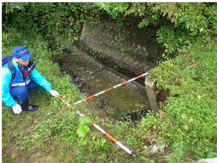
被災状況調査状況 宮城県角田市 尾袋川 被災状況(護岸吸い出し)
