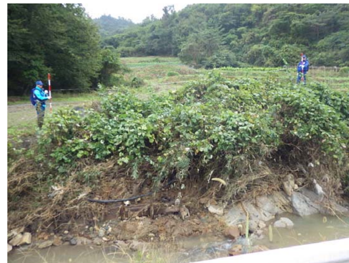
被災状況調査状況 宮城県角田市 高倉川 被災状況(洗掘)
