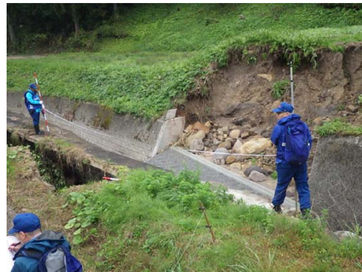
被災状況調査状況 宮城県角田市 笠島川 被災状況(護岸崩落)
