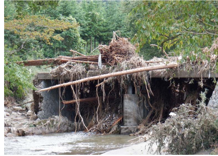
被災状況調査状況(調査⑦)
