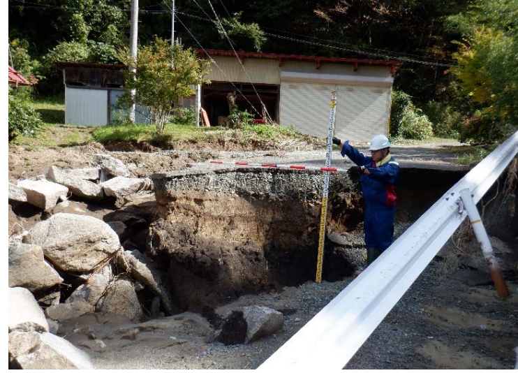
被災状況調査状況(調査⑥)
