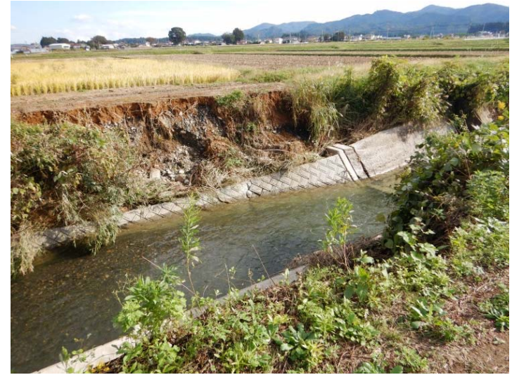
被災調査状況 (福島県白河市 坂下川)
