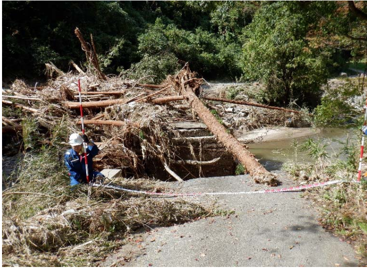
被災状況調査状況(調査⑦)
