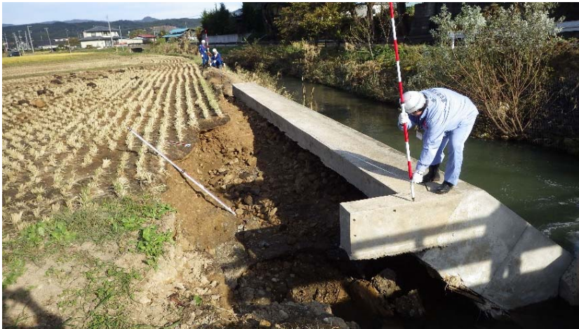
阿由里川 左岸 護岸損傷状況を調査 (福島県矢吹町三城目地区 阿由里川)
