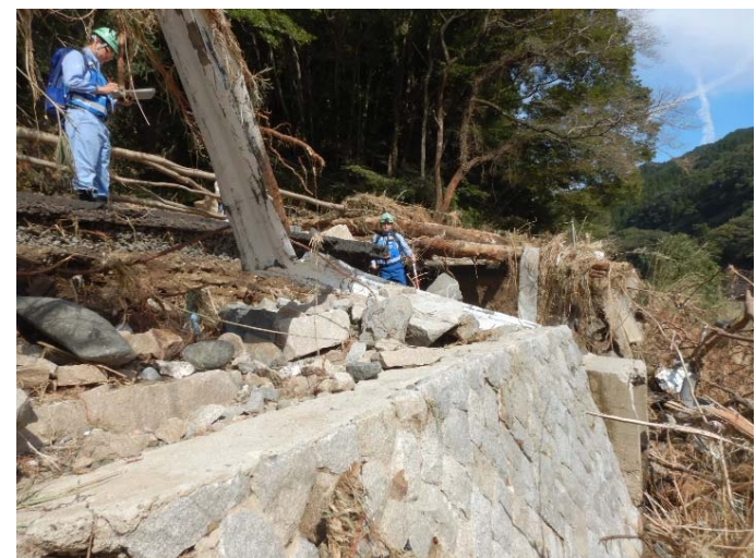
被災状況調査 (宮城県丸森町 R349)
