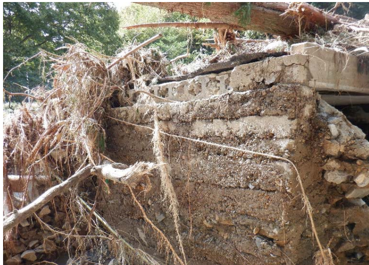
被災状況調査状況(調査⑦)
