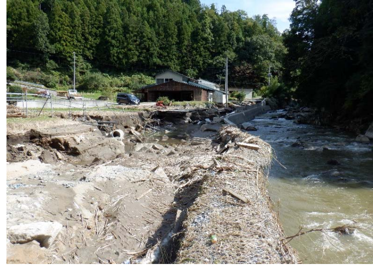
被災状況調査状況(調査⑥)
