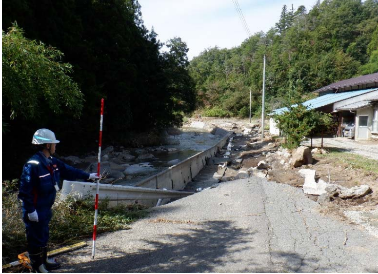
被災状況調査状況(調査⑥)
