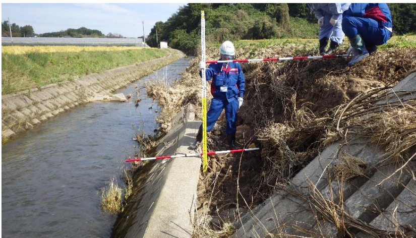
阿由里川 右岸 護岸損傷状況を調査 (福島県矢吹町白山地区 阿由里川)
