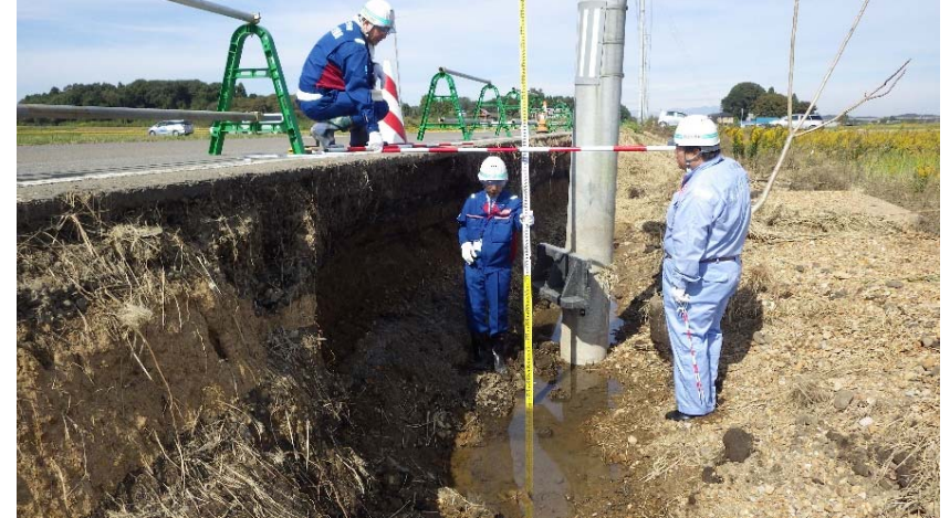
町道 明新陣ヶ岡線 法面崩落状況を調査 (福島県矢吹町陣ヶ岡地区)
