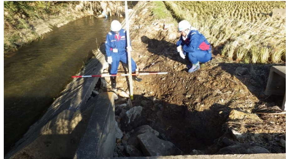
阿由里川 護岸損傷状況調査 (福島県矢吹町白山地区)
