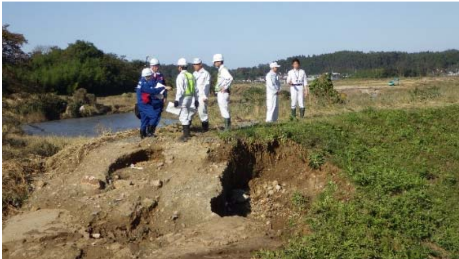
現地被災状況調査 (阿武隈川・阿由里川合流点)
