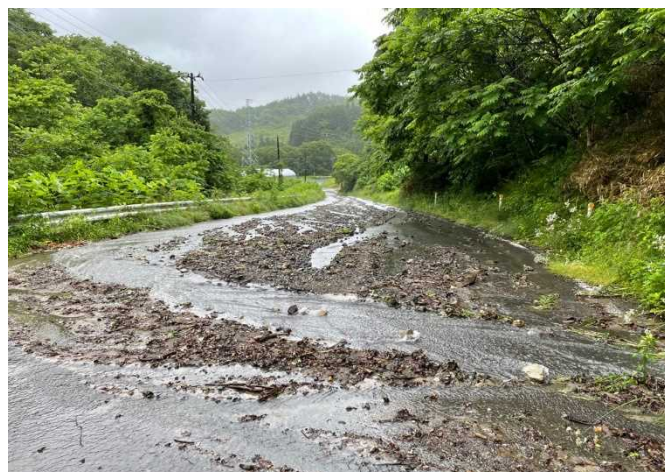
・砂利道からの碎石流出の状況
