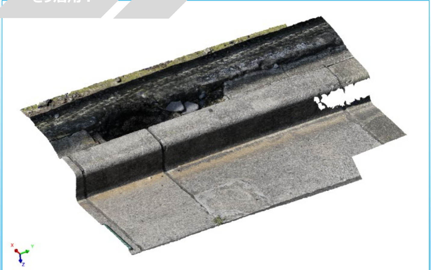
ん？「どの範囲で壊れたんだろう？」を撮影
