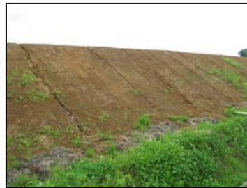
写真-2 法面のガリ浸食(1)
