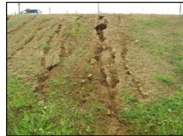
写真-3 ガリ浸食と植生不良
