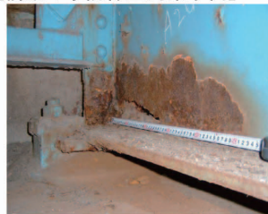
対策前(主桁の腐食・亀裂)
