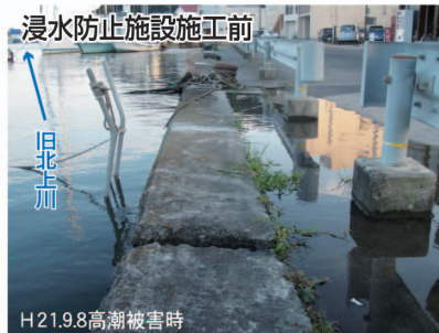
H21.9.8高潮被害時
