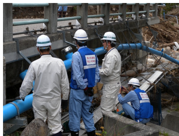
TEC-FORCEによる現地調査状況(南会津町) (14日11:30)
