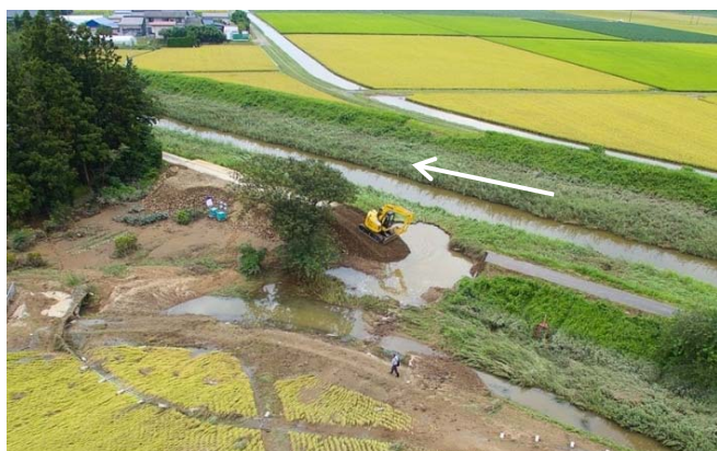
上流工区破堤箇所(13日12:00)
