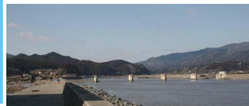
▲国道45号気仙大橋被災状況
