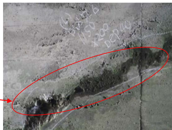
樋門函体のクラック発生状況
