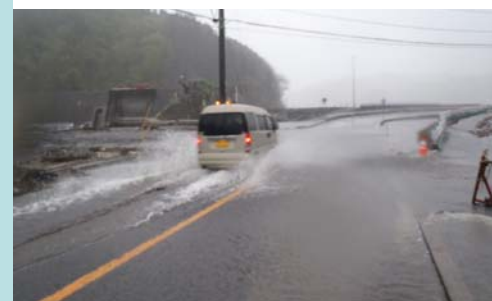
釜石市両石地区 国道45号の冠水状況
