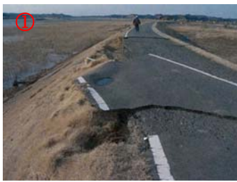
【左岸 0.4k~1.8k】 ・土堤(道路兼用堤防)の表裏法面で部分的に洗掘あり。
