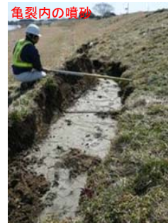
亀裂内の噴砂
