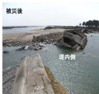
河川堤防と海岸堤防の接合部分が津波によって決壊
