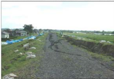
H15地震後の被災状況(天端沈下・亀裂)
