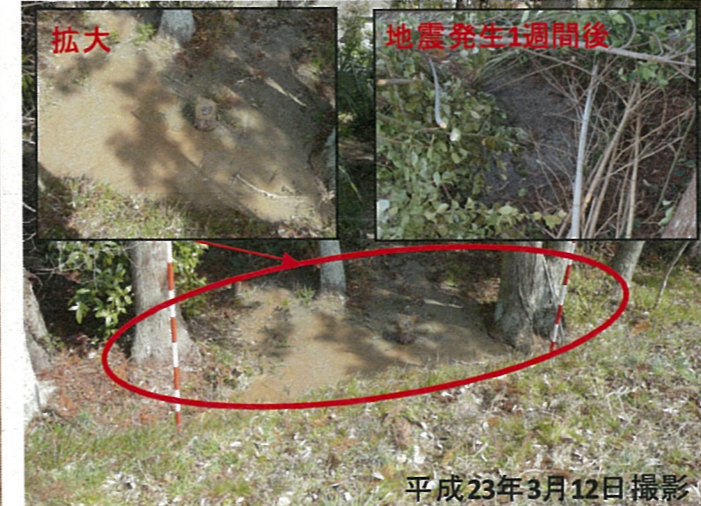
③右岸30.8k付近: 川裏のり尻 土砂流出状況 暗灰色の細砂が分布。砂は高含水である。
