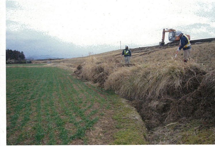
④右岸31.2k付近: 川裏のり尻 堤体押し出し状況 押し出し幅=3.00m程度。
