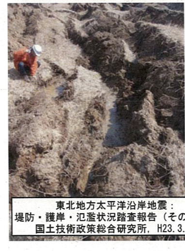
写真② クラック内は水たまり、高含水の砂質土が充填されている
