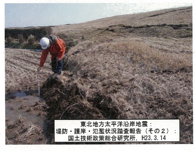
写真④ 裏法尻のほらみだし状況 末端部ではほらみだしが見られる
