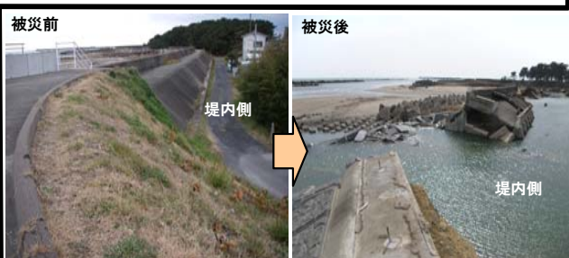
河川堤防と海岸堤防の接合部分が津波によって決壊
