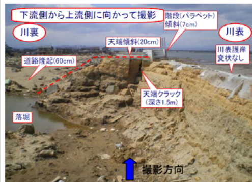
【写真①】津波洗掘断面を、下流側から上流側に向かって撮影。天端に2本のクラックが発達する。深さは1.5mほどである。天端が川表側に低く傾斜する。逆にパラペットは川裏側に傾斜する。川表の護岸に変状は見られない。川裏の道路が約60cm隆起する。
