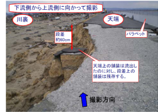
【写真④】天端の段差と舗装の残存状況。下流側から上流側に向かって撮影。段差は約60cm。舗装が、天端上では流出しているのに対し、段差上には残存する。推測として、津波到達前に段差の発生していた可能性が考えられる。
