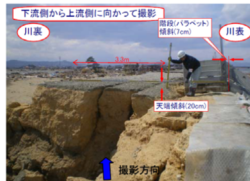
【写真②】天端傾斜の状況。幅3.3mに対して、川表側が20cmほど低い。前述したように、逆にパラペット(階段)は7cmほど川裏に傾斜している。
