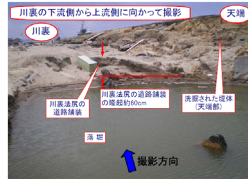
【写真③】川裏法尻付近の道路の変状(傾斜)状況。川裏法尻付近を下流側から上流側に向かって撮影。法尻付近の道路の舗装が、横断方向の法尻のほうが隆起している。60cm程度である。手前は落堀である。
