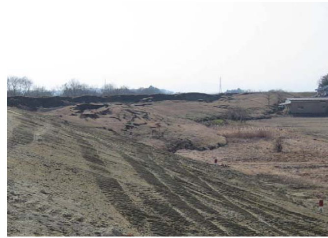
写真③ 裏法のほらみ出しが見られる
