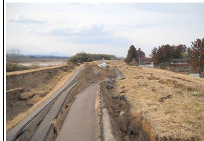
②右岸31.0k付近: 天端縦断クラック 堤体沈下量=2.30m。
