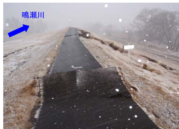
写真①: 天端に沈下による横断クラック
