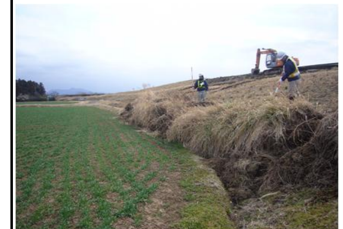
④右岸31.2k付近: 川裏のり戻り土砂流出 堤体押し出し状況 押し出し幅=3.00m程度。
