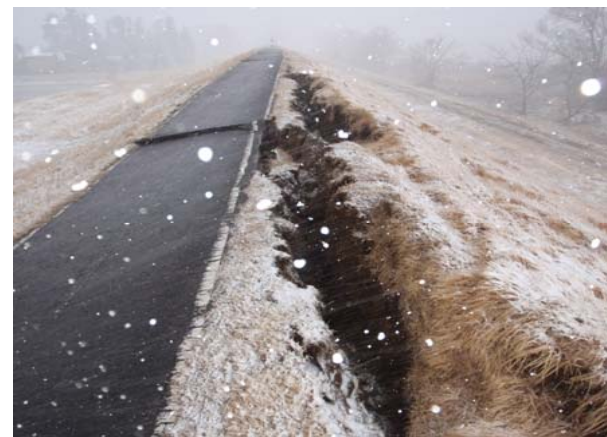
写真②: 堤内法肩に縦断クラック L=150m
