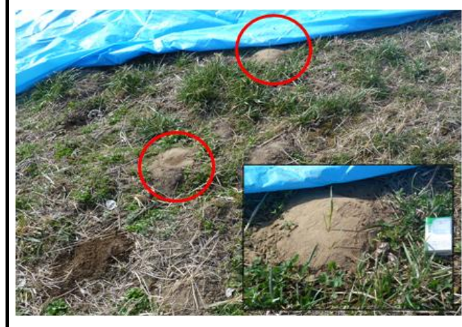
④噴砂状況 川裏側のり面で複数確認される。細粒砂主体。
