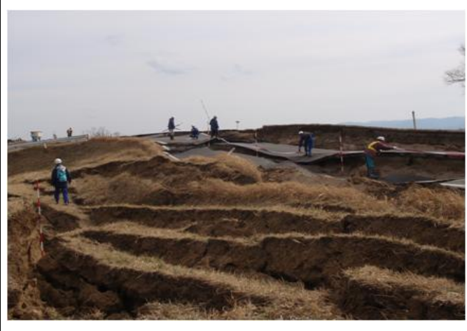
②川裏法面状況：縦断クラック発生 深さは20~100cm程度である。
