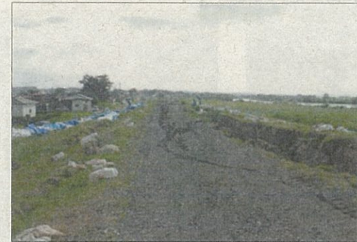
H15地震後の被災状況(天端沈下・亀裂)
