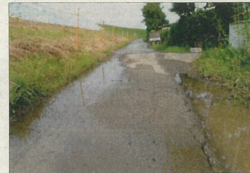
H15_川裏尻からのしみ出し(地震後)
