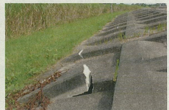
H15被災状況(川裏護岸コンクリートの亀裂)
