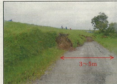
H15地震後の被災状況(川裏法尻の水平変位)
