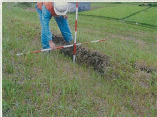
H15被災状況(川裏法面の縦断亀裂)
