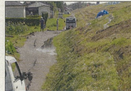
H15地震後の被災状況(川裏法尻隆起変形)
