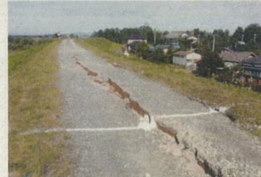
H15地震後の被災状況(天端縦断亀)
