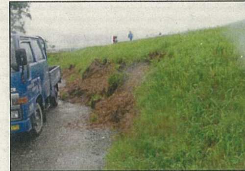
H15地震後の被災状況(崩壊・泥土化した堤体)
