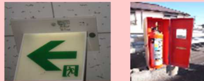
点灯しない電池切れの避難誘導灯
