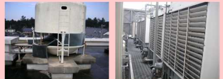
壊れかけた冷却塔
