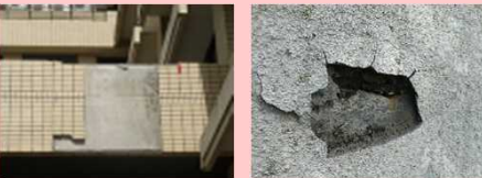
外壁タイルの一部が階下へ落下
